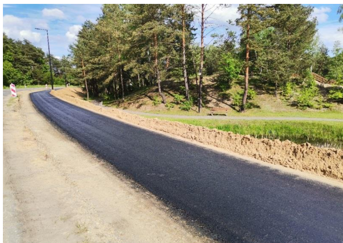
Budowa ścieżki rowerowej na szlaku rowerowym „Lublin- Wola Uhruska” w trakcie realizacji
